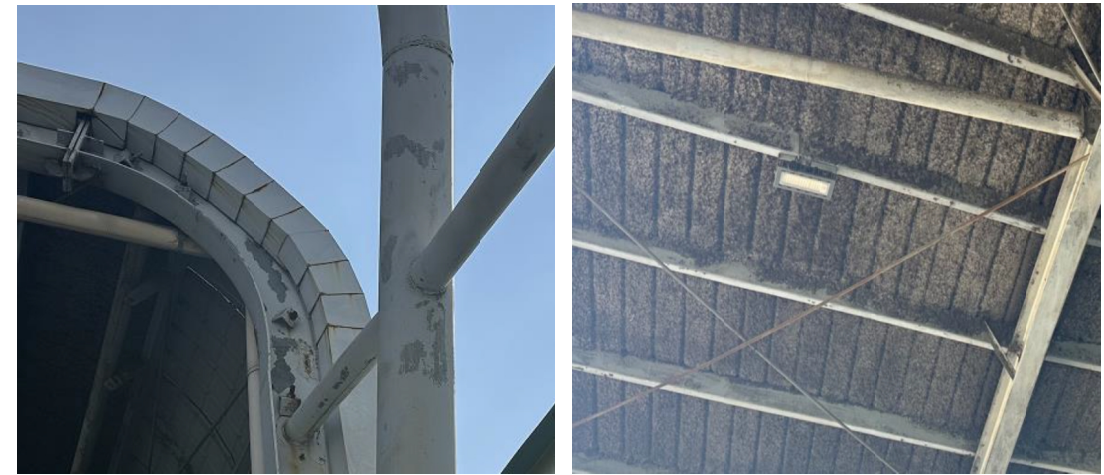
涂层脱落，装饰板变形
