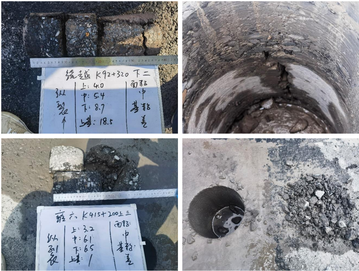
图 3.6-3 纵向裂缝芯样
