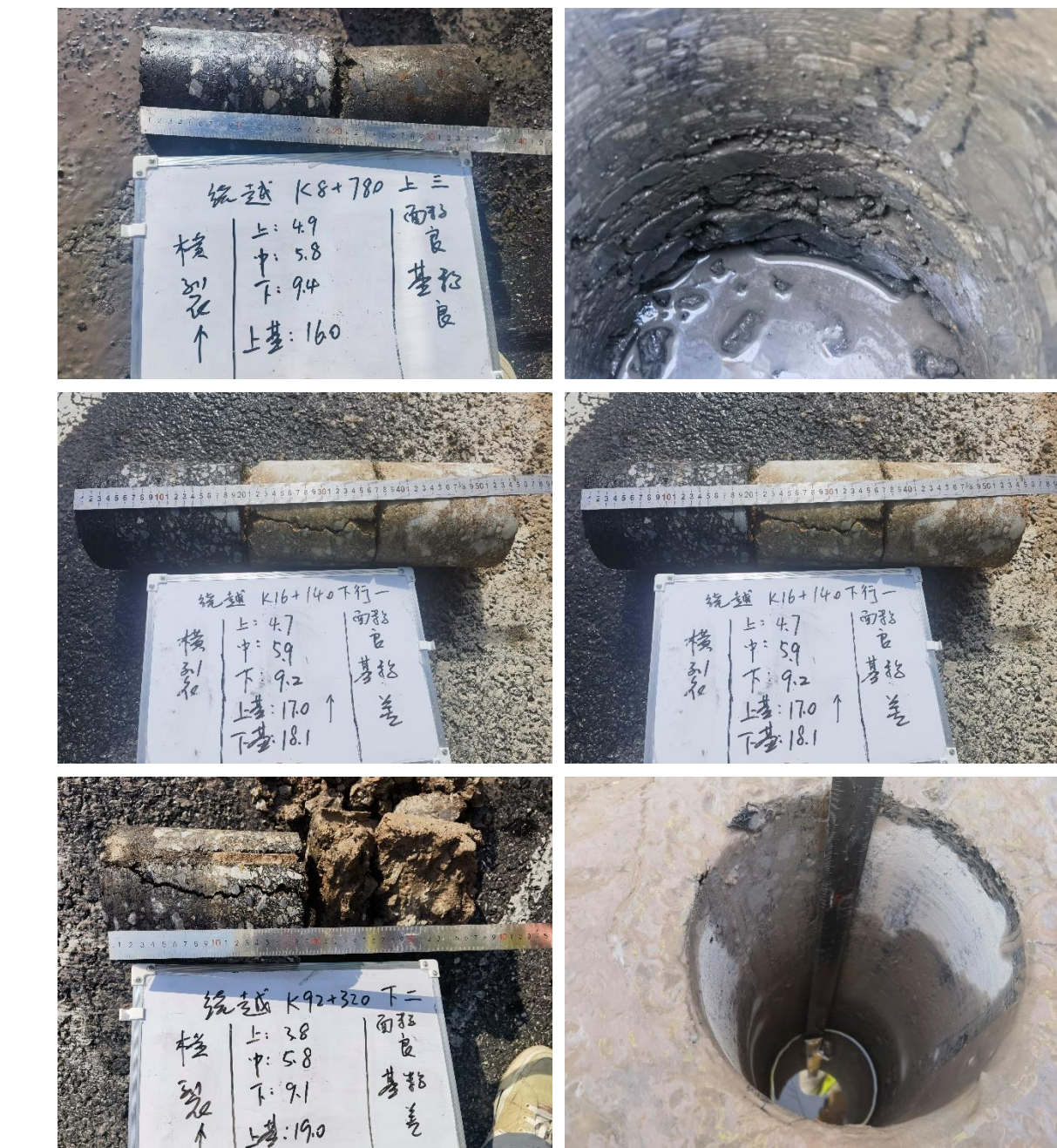
图 3.6-2 横向裂缝芯样
